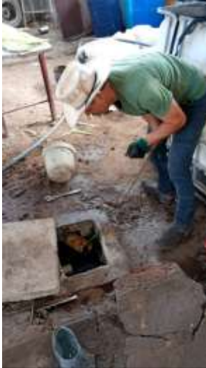
Tenencia de Chila, destapando drenaje en vivienda.
